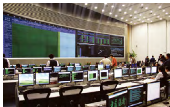
中国银行信息系统运行维护总控中心
